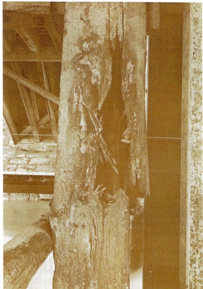
Ein «zerfallener und geknickter Eichenpfahl» vom Joch 4, der 1915 zum Absacken der Fahrbahn um 20 cm geführt hat.
