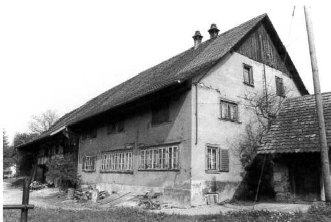
Das GNEPFEN-Haus im Jahre 1981, als noch der letzte Bauer der Familie GNEPF darin wohnte. An der Stirnfront und der Südfront zeigen Schäden die dicke Verputzschicht, die 1903 auf die Riegelfassade gepflastert worden ist. P.W. 1981
