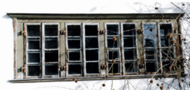
«Fensterwagen» am Haus GNEFF mit «eingehängten» Vorfenstern. An den mittleren Fenstern hat es je ein «Guggeerli».
