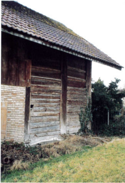
Nordansicht des Bohlenständerteils des Speichers. Die Eichenschwelle über einem Steinfundament und die drei eingezapften Ständer mit den eingelegten Bohlen sind typisch für diese Bauweise. Im Obergeschoss sind die Bohlen wohl später erneuert worden.
