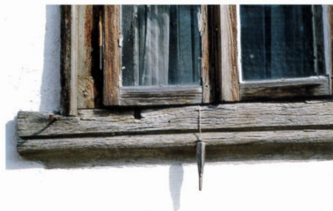
Holzstöpel dienen zum Fixieren der geöffneten Fenster und Vorfenster.
