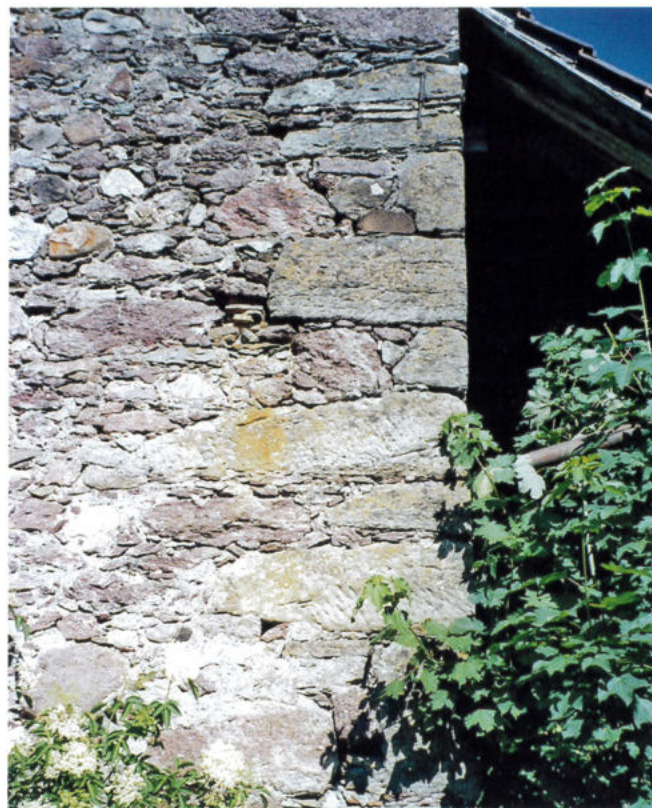
Für die Wetterschutzmauern der Dreisässen Häuser hat man nur in den Eckpartien ausser Ackersteinen auch leichter behaubare Sandsteine verwendet und zwar in möglichst grossen Blöcken (WAGNER-HEIRI-Haus). Die kleineren Bruchstücke der Ackersteine fanden eher im Mauerwerk der Waschhäuschen Verwendung.
