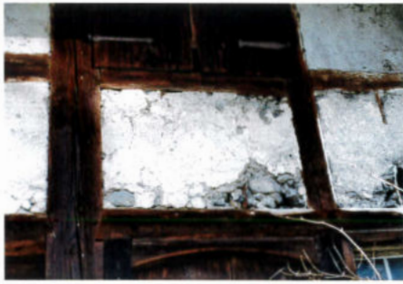
Die Ausmauerung der Fachwerkbauten bestand an den Aussenwänden aus Bruchsteinmauerwerk (Haus GNEPF).
