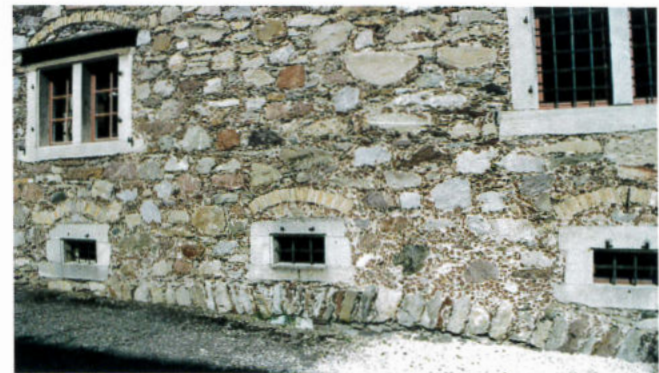
Eine ganz besondere Konstruktion zeigt die Wetterschutzmauer des Hauses Schmider. Da der Baugrund am Abhang nicht homogen war, hat man die Hauptmauer des grossen Weinkellers auf der Westseite mit einer lang gestreckten Bogenkonstruktion überwölbt. Mit dieser Konstruktion konnte man die Hauptlast der Wetterschutzmauer auf die Gebäudedecken verlagern, so dass die Wetterschutzmauer bis heute keine Risse bekam, obschon der Untergrund nicht optimal war.
