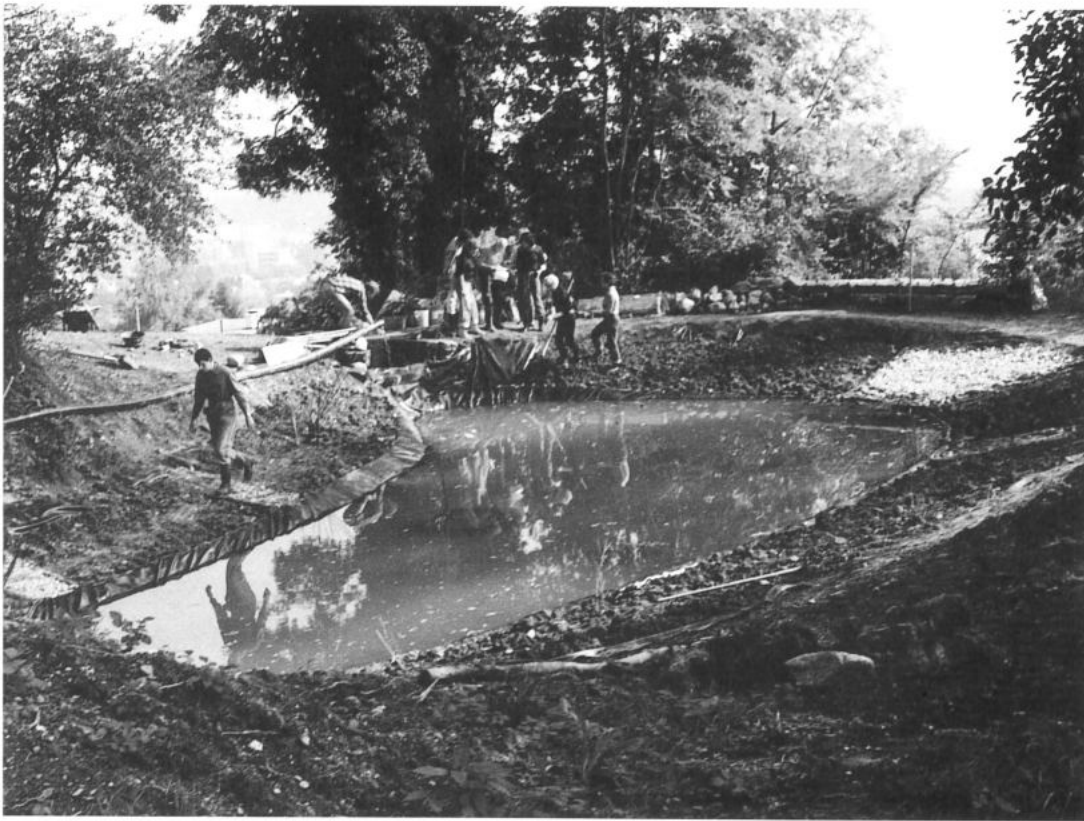
Sanierung des Feuerwehrweihers in Fronarbeit. Die Sohle des Weihers wird mit einer Kunststoffolie abgedichtet. (Foto FRITZ SEILER)
