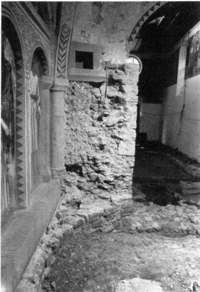
Abb. 2 Südlicher Chorbogenpfeiler von Osten her gesehen; links die Anpassung an die Wandflucht des Rechteckchores (Tuffsteinquader).
