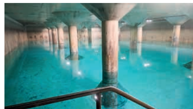
gereinigtes Reservoir mit neuer Beleuchtung
